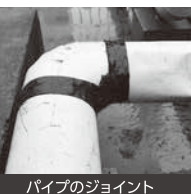
パイプのジョイント
