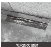
防水層の亀裂
