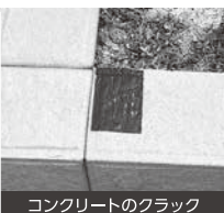
コンクリートのクラック
