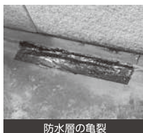
防水層の亀裂
