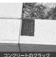
コンクリートのクラック
