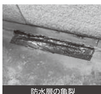
防水層の亀裂
