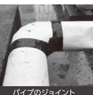
パイプのジョイント
