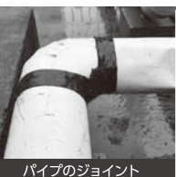
パイプのジョイント
