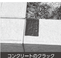
コンクリートのクラック
