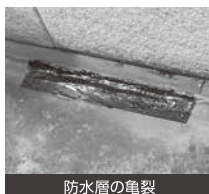
防水層の亀裂
